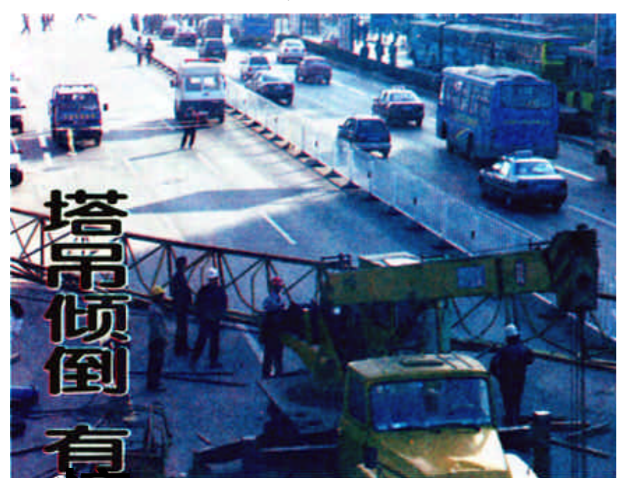
塔吊倾倒 有惊无险
